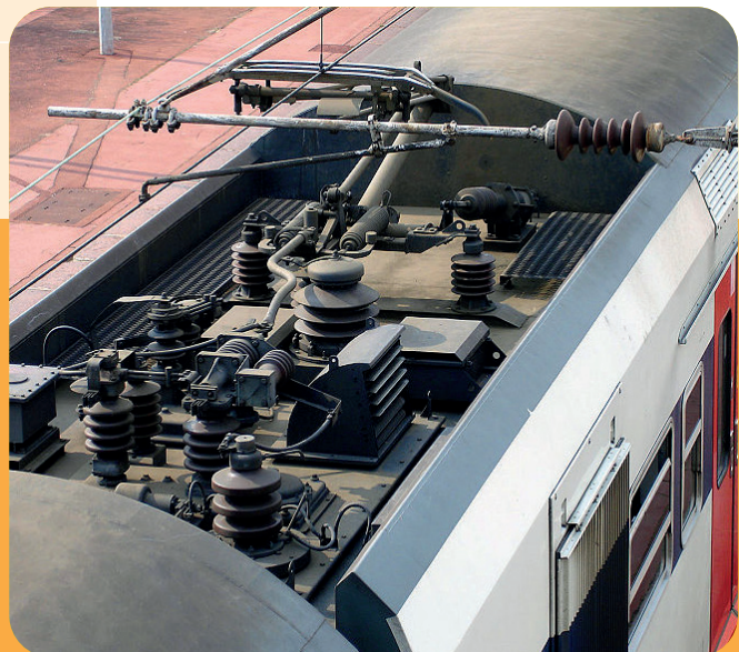
Lubrification dynamique, sous HT, de pantographes.
